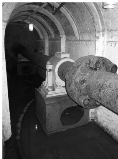
ПРИЛОЖЕНИЕ 2. ФОТОФИКСАЦИЯ. Фото 38,39. Насосная.
