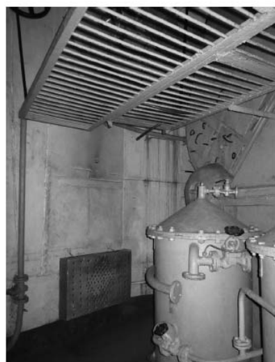
ПРИЛОЖЕНИЕ 2. ФОТОФИКСАЦИЯ. Фото 35,36. Машинное отделение. Фото автора 2013г
