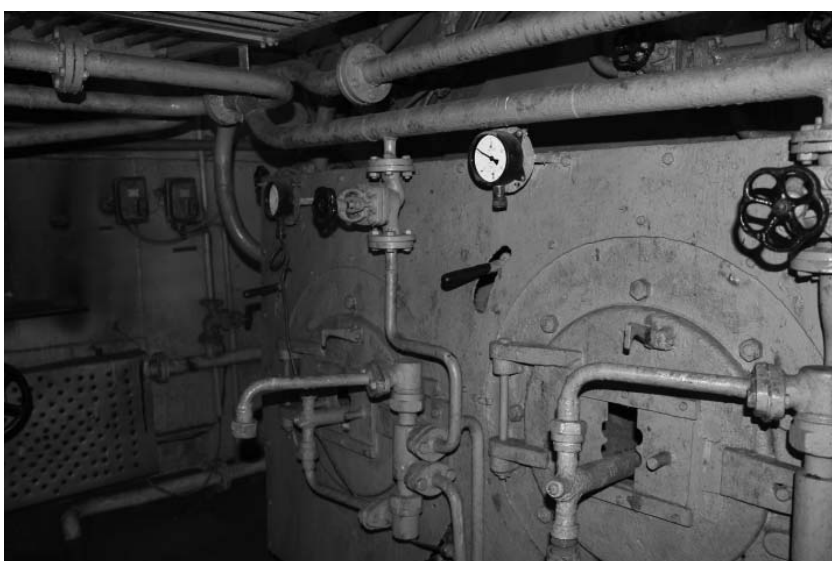
Фото А.А. Жильцов, август 2018 г. Топки парового котла.
