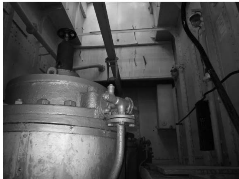
ПРИЛОЖЕНИЕ 2. ФОТОФИКСАЦИЯ. Фото 33-а Машинное отделение. Фото автора 2013г
