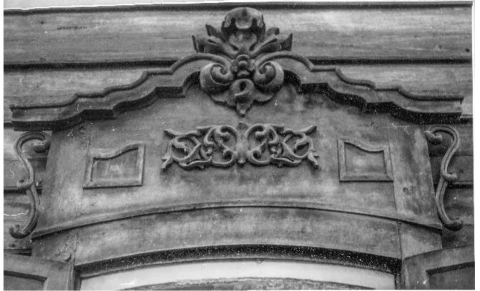
Фото 15. Пер. Черемховский, 4, лит. А. Верхняя часть оконного наличника северо-восточного фасада. Фото В. Щербина, нач. 1980-х гг.
