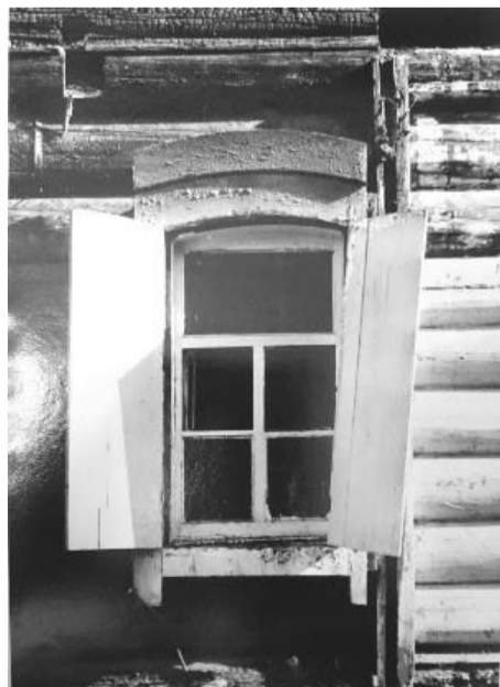
Фото 19. Пер. Черемховский, 4, лит. А. Наличник оконного проема 1-го этажа юго-западного фасада. Фото 1993 г.
