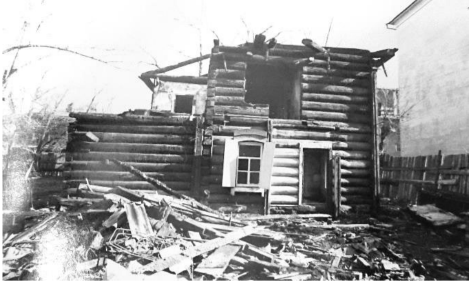
Фото 12. Пер. Черемховский, 4, лит. А. Юго-западный фасад. 1993 г.
