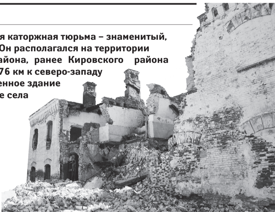
После обрушения видно, что стены почти метровой толщины
