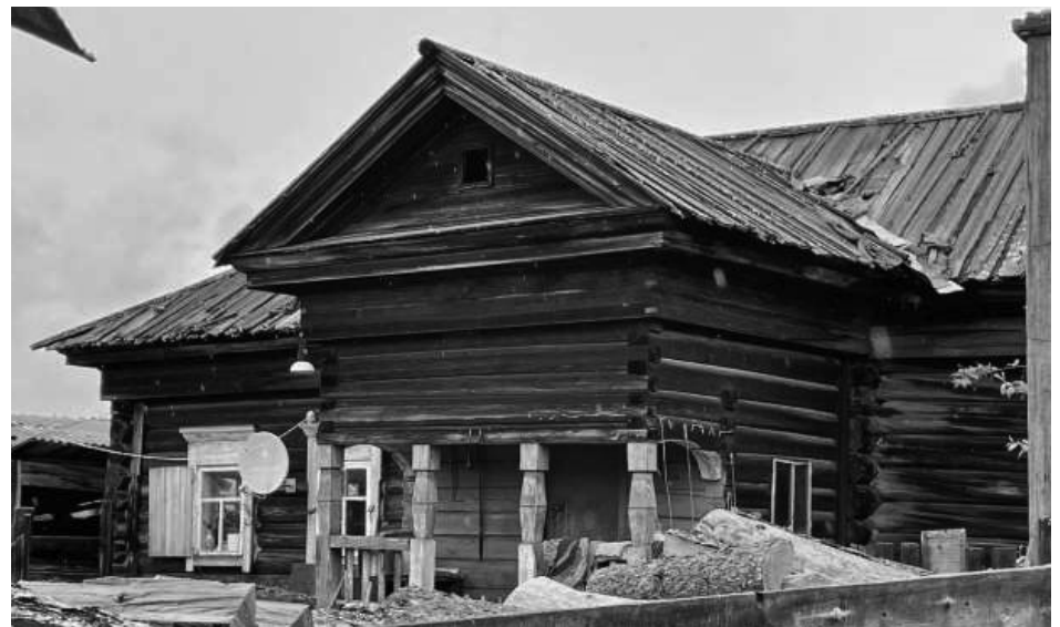
Фотография № 2. Вид с ул. Центральная на юго-западный фасад объекта культурного наследия
