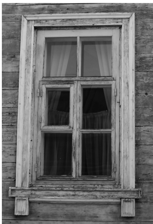
Фото 15. Наличник оконного проема первого этажа, юго-западный фасад.
