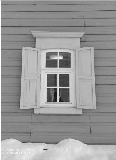
Фото 7 – Северо-восточный фасад (дворовой). Декор наличника
